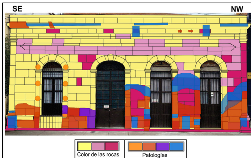
Figura 9. Sobreposición de la cartografía y las patologías presentes en la fachada del inmueble. Para mayor información sobre el tipo de rocas en esta figura, ver Figuras 6 y 7.
